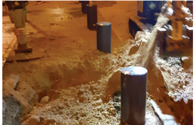
3/01 : Images spectaculaires de la rupture de la canalisation survenue avenue Jean Jaurès.
